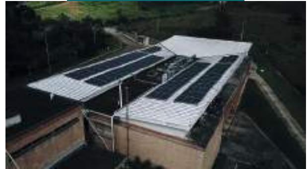
Paneles solares Campus Universitario
